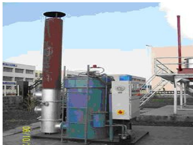
A glimpse of mini boiler
